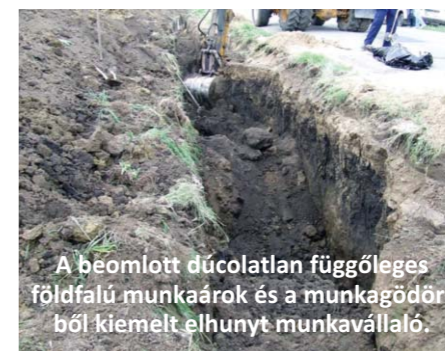
A beomlott dúcolatlan függőleges földfalú munkaárok és a munkagödörből kiemelt elhunyt munkavállaló.
